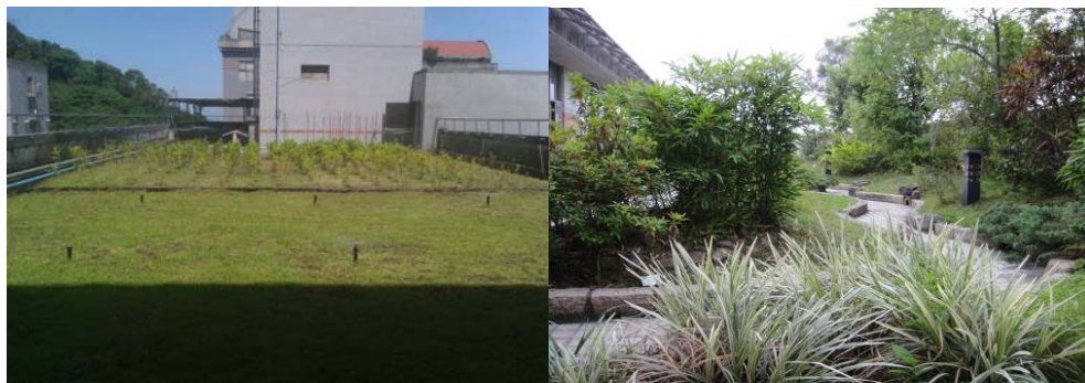
圖 6.2 屋頂隔熱系統(左：教學大樓、右：設計大樓)
